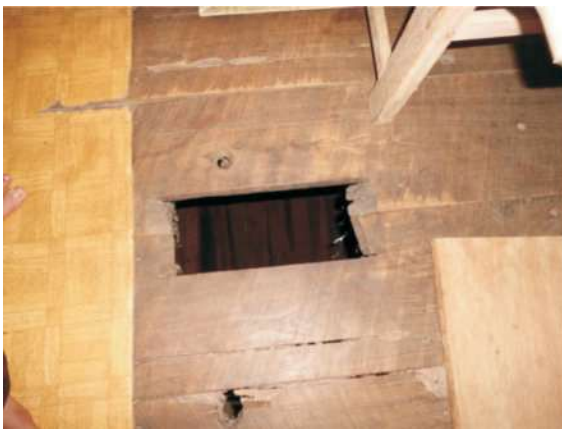
Gambar 3. Lubang Lantai untuk Membuang Kotoran
